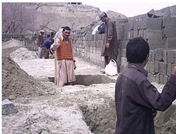
Stavba je na písku a musí mít hluboké základy
